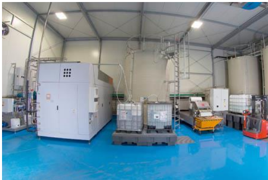
Bild Nr. 09-03 MK_RU-Gesamtanlage.jpg. Mit der Verantwortung für das Gesamtprojekt hat MKR Metzger Kompetenz im Großverdampfer-Anlagengeschäft bewiesen.
