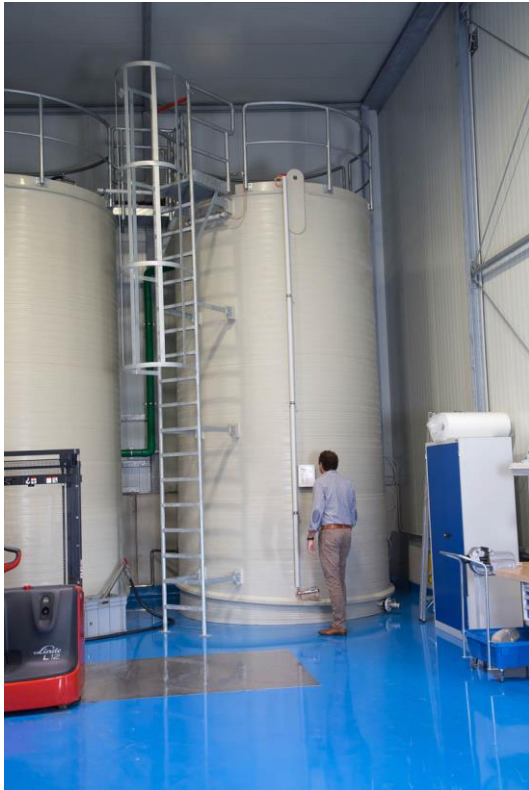
Bild Nr. 09-05 MK_RU-Tank.jpg. Gesteuert und überwacht wird der gesamte Vorgang durch eine Software.
